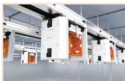
Equipo OHT (transporte con polipasto aéreo)
